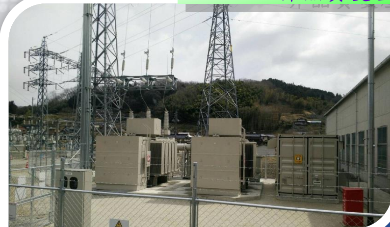
日本-太陽能電廠智能升壓站 非晶質變壓器
