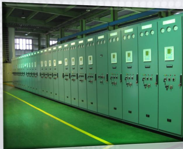
氣體絕緣開關設備
