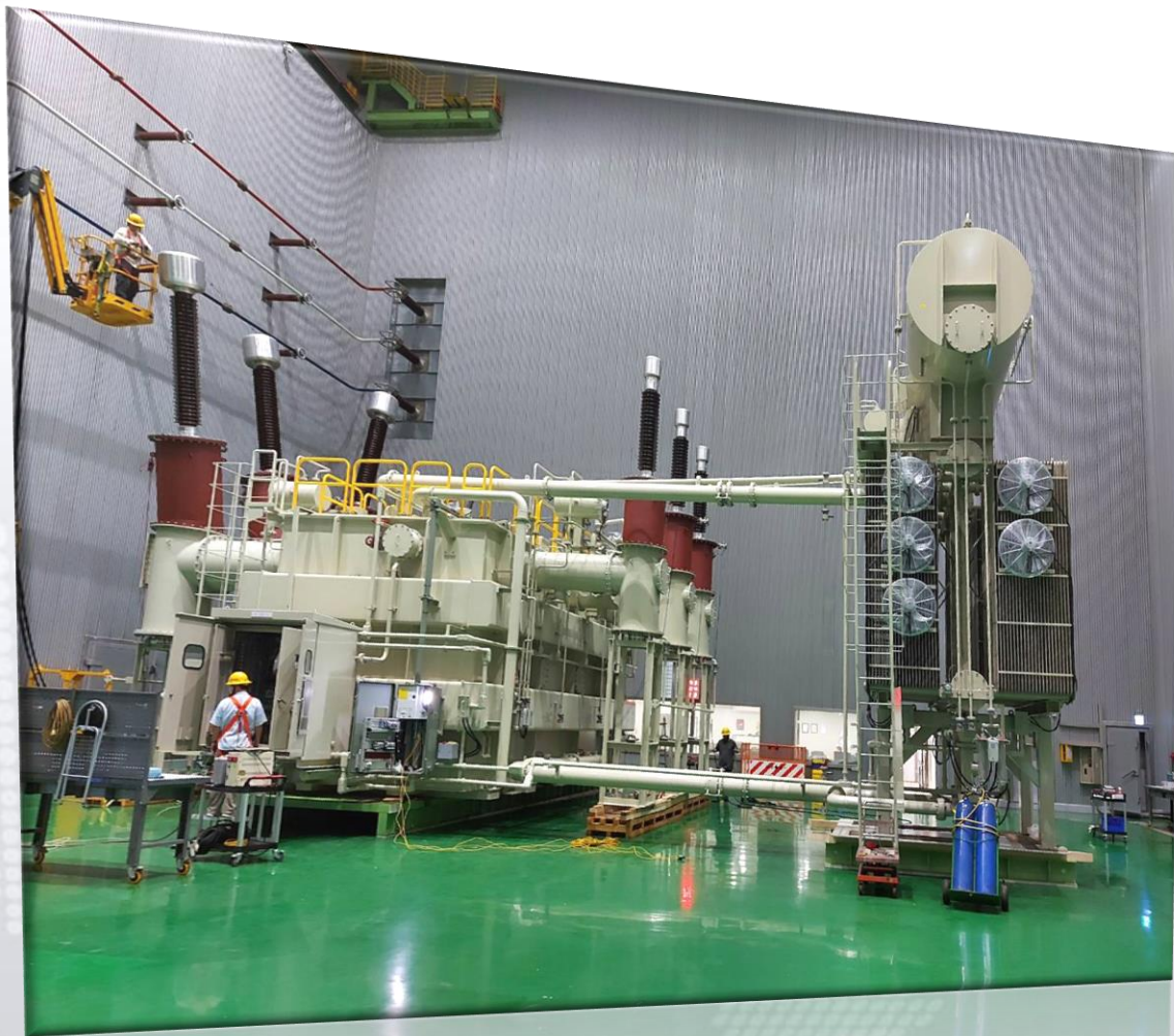
2020年完成離岸風電特高壓變壓站230kV 360MVA電力變壓器
