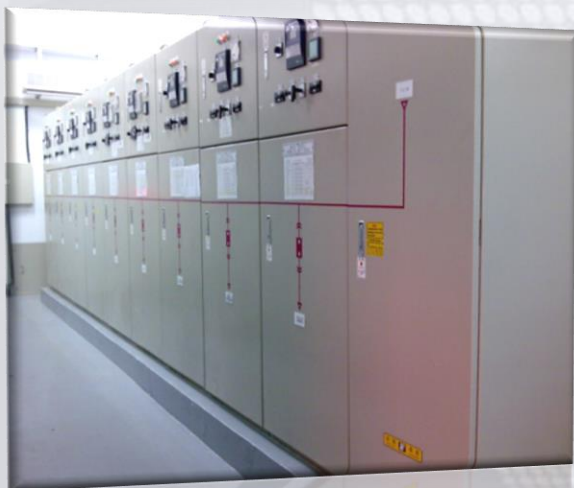
屋內型23 kV配電盤
