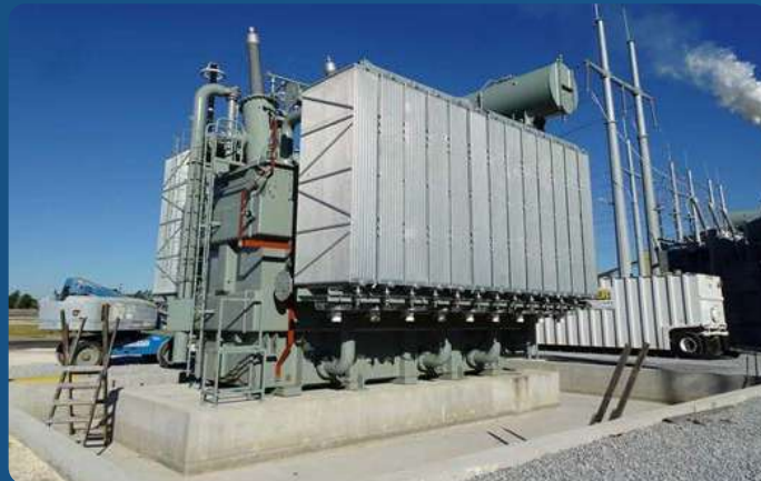
▼ 232kV 510MVA，該現地共交貨 6 台
