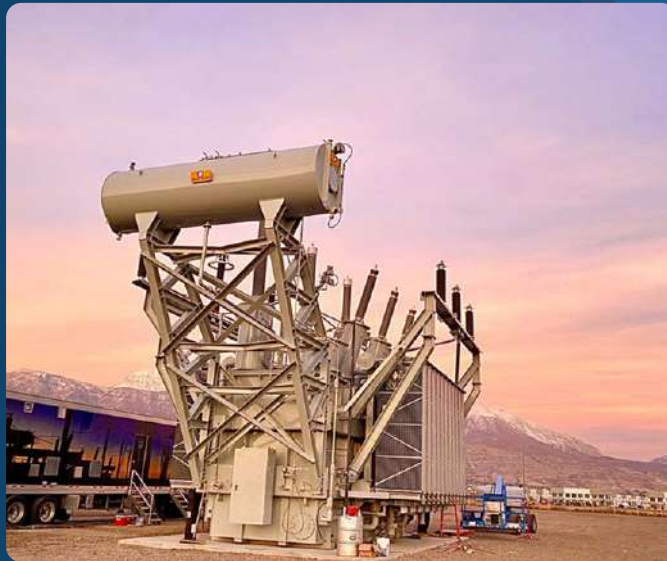
▼ 美國西北區 700MVA 超大型電力變壓器
