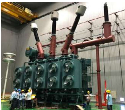
▲ 台電電廠及太陽能漁電共生案場用
