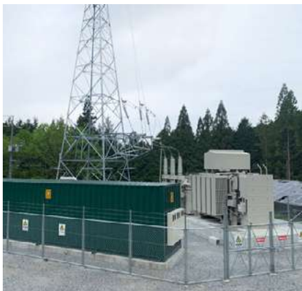
▲ 日本太陽能發電廠 PV BOX
