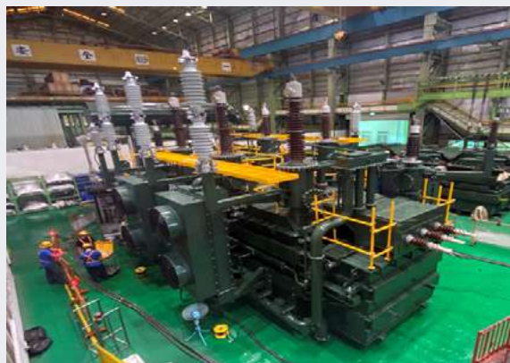
▲台電公司新桃供電區營運處
